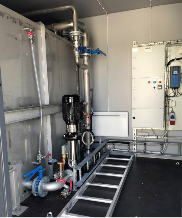
Kuva 2. Laitteet on sijoitettu kontin etuosaan eristettyyn ja valaistuun laitetilaan.
