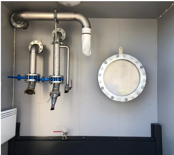
Kuva 3. Myös kontin takaosan venttiilitila on lämmitetty.
